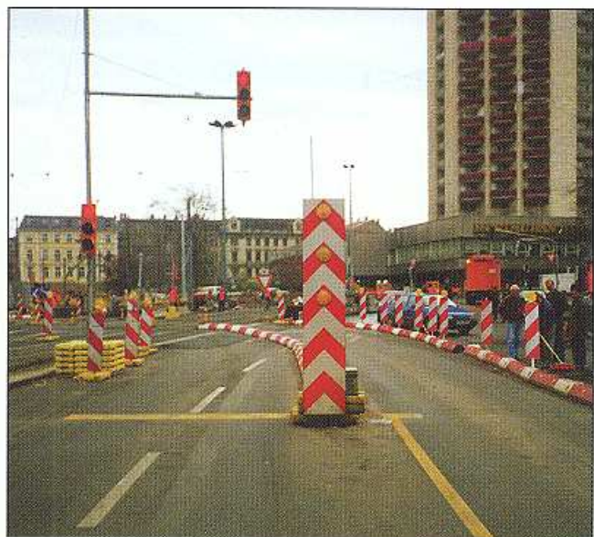
Fahrbahnteiler in Verbindung mit Leitborden ergeben eine eindeutige Verkehrsführung.
